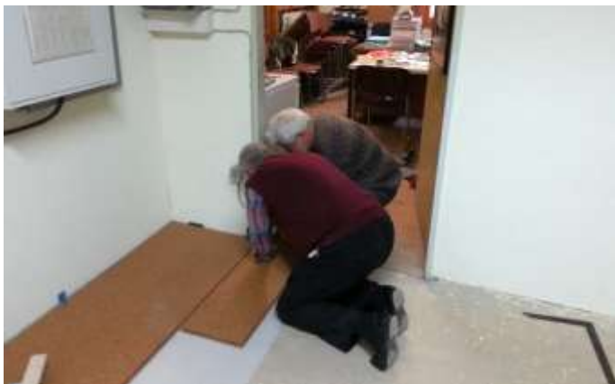
Und hier beim Verlegen des Korkfussbodens durch E-Mobil Fahrer ganz unterschiedlicher Art: Renault Fluence und CityEL mit NiCd-Akkus und Solardach
